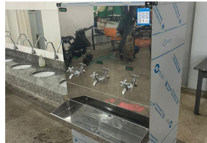
Bebedouro da EMEB Sebastião de Camargo Pires instalado
